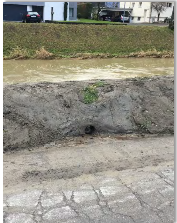
Entlastungsöffnung mit Rückschlagklappe
