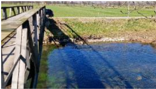
Erosion der Böschung am RBK, Lindenmaadsteg, Kriessern
