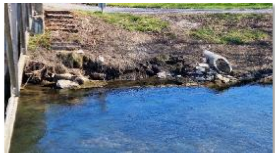
Erosion der Böschung am RBK, Lindenmaadsteg, Kriessern
