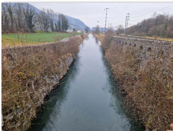
Bewuchs Rillisdammschleuse, Blick nach Norden, Lienz
