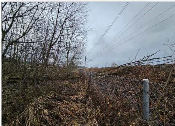
Windwurf, ÖBB Gleis, Bruggerhorn
